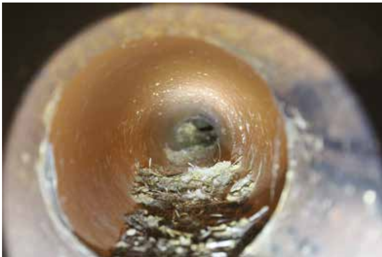
Obr. 3. Lokalita č. 1, pohled do drenážní trubky. Foto: P. Benda.
