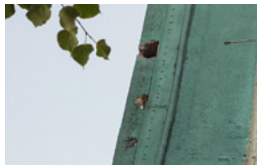
Typische Schäden an einer Fassade in der Wärmedämmung
