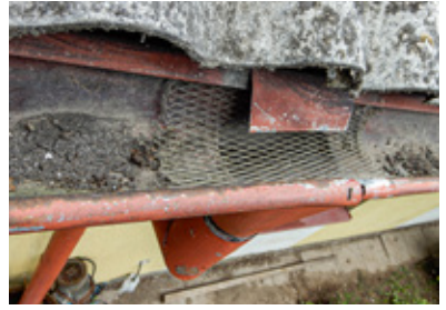
Regentraufen, insbesondere diejenigen, die unterirdisch münden, sind durch ein Geflecht abzusichern
